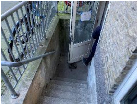
Udvendig trappe ned til bla. Vaskekælder fremstår generelt i god stand.
