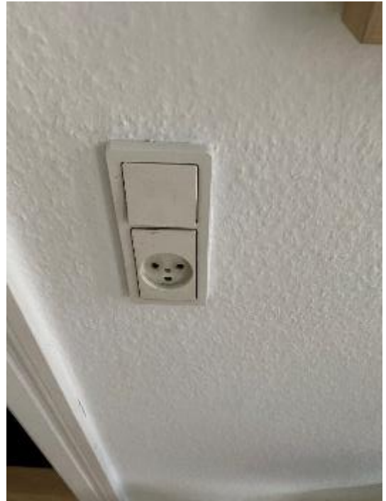
Planforsænket kontaktmateriel i en bolig. Stikkontakten er med jordben og det antages at installationen er med beskyttelsesleder (jord), hvilket var påkrævet ved udførelsestidspunktet.
