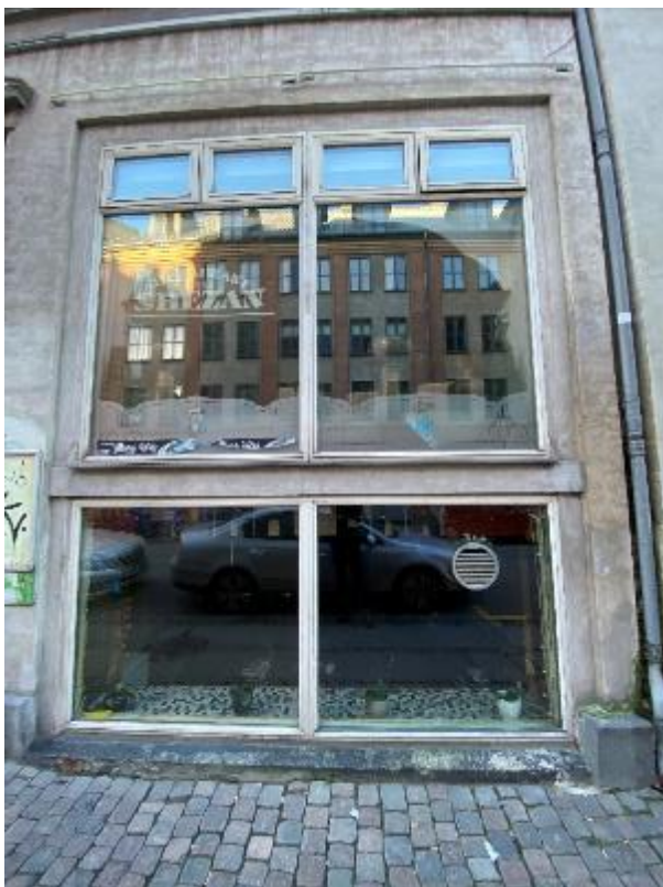
Vinduesparti mod erhvervslejemål i stueetage mod gadesiden. Disse partier fremstår generelt meget slidte.
