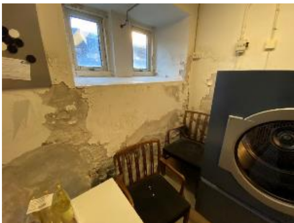
Fundamenter og kælderydervægge er grundmurede og pudset indvendigt. Der ses skader fra opstigende grundfugt i mindre grad.
