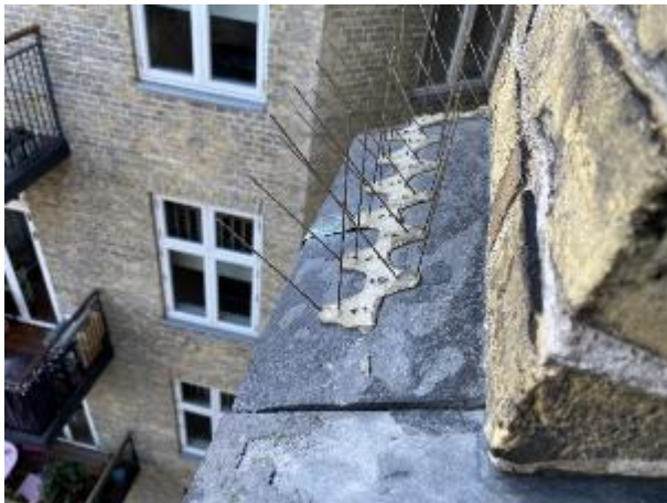
Der er nogle steder udført duesikring på gesimserne – men ikke konsekvent overalt.
