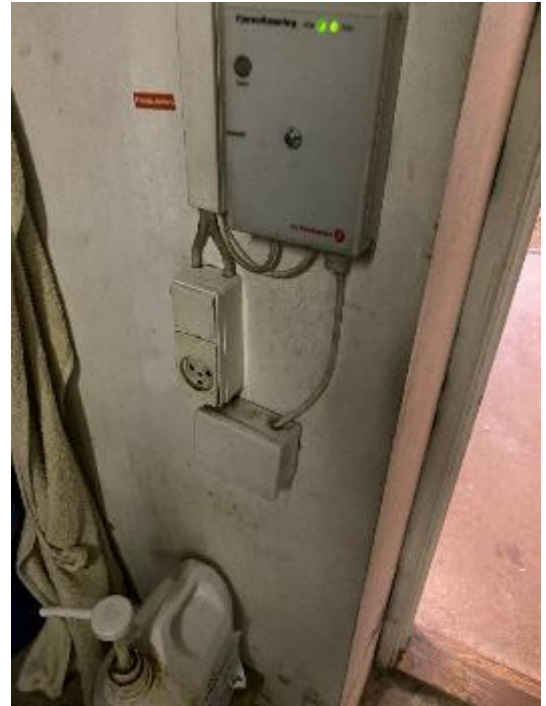
Endnu en fællesinstallationer i varmecentralen
