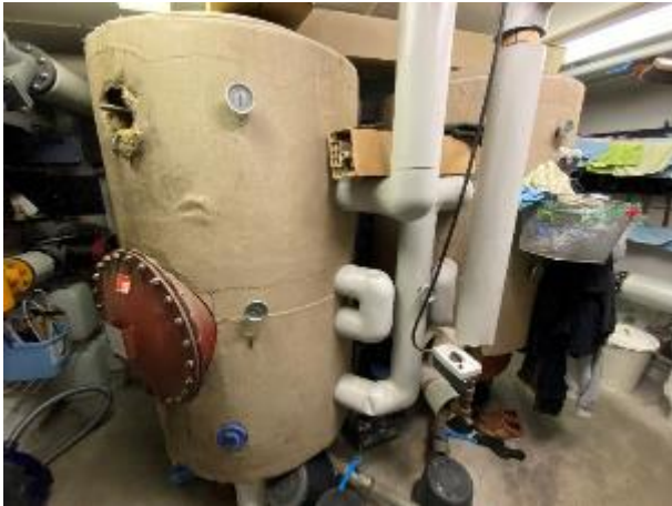
Varmtvandsbeholderne (isoleret) mangler isolering på manddæksel generelt
