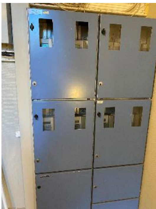
En fordelingstavle på bagtrappe som forsyner boliger samt erhvervslejemål. Afregnesmålerne placeret i tavlen er for de enkelte boliger i pågældende opgang.
