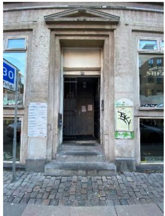
Udvendig trappe på gadeside til opgang. Trin i granit er i god stand, men tilstødende chaussé sten ligger løst.
