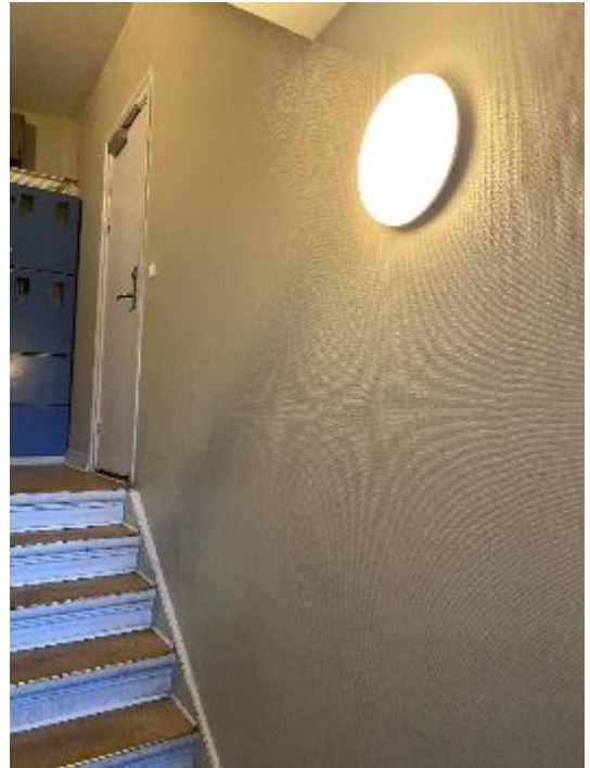
Belysningsarmatur på bagtrappeopgange. Armaturet er med LED og intergreret bevægelsesmelder for automatisk tænd/sluk af loftbelysningen
