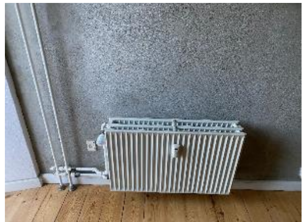
Radiator placeret på indeliggende væg efter altanprojekt.
