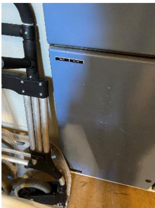
Et tavlefelt hvori sikringer for erhvervslejemål er placeret. Det er "umålt strøm" hvilket betyder at afregningsmåleren er placeret i erhvervslejemålet.
