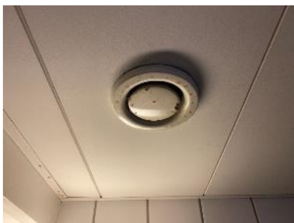
Kontrolventil i badeværelsesloft med rustangreb
