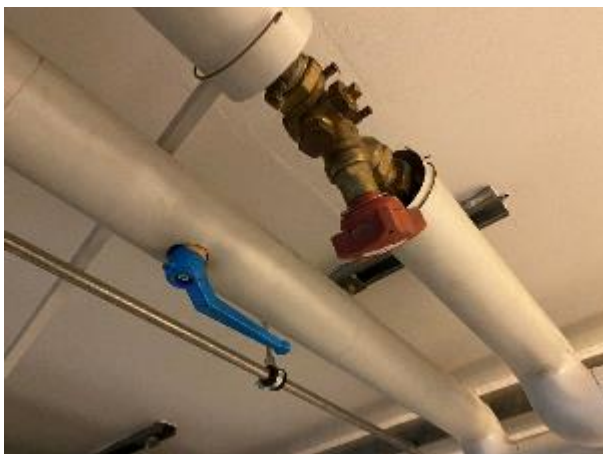
Afgrening til varmestigstreng med statisk strengregulering og afspærringsventil (manglende indreguleringsmærkat og isoleringskappe)
