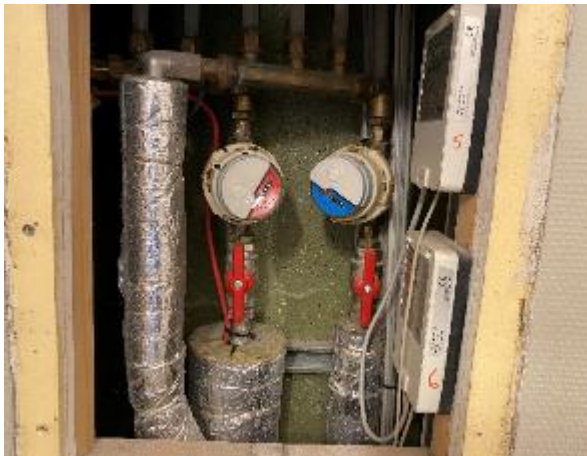
Isolerede stigstreng i skakt, bi-vandmålere, messing fordelere, messing ventiler og omløbere
