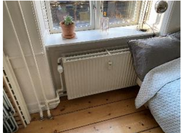
Panelradiator i brystning under vindue og tilslutning til stigstreng
