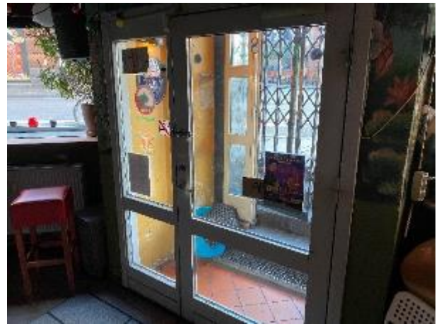
I størstedelen af kælderen er der indrettet erhverv, og der var ved besigtigelsen kun adgang til en mindre del af kælderen. I erhvervslokalerne er bygningsdelene mange steder skjulte.
