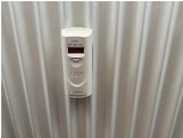
Elektronisk fordelingsmåler på radiator
