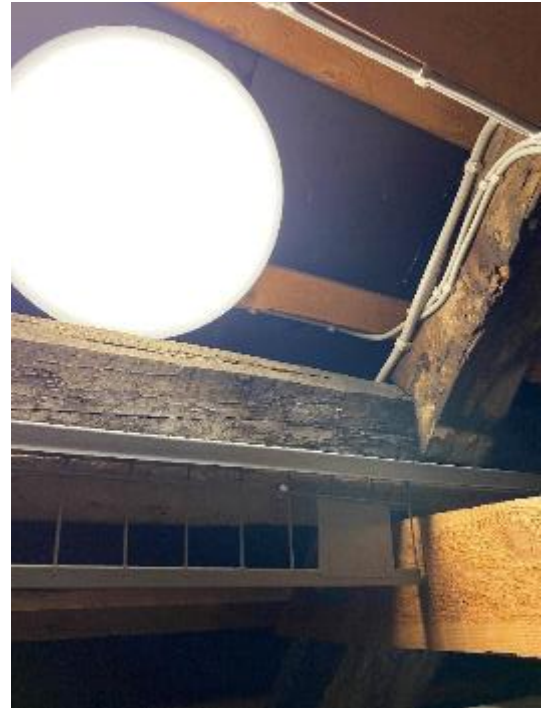
Belysningsarmatur på loftet. Armaturet er med LED og integreret bevægelsesmelder for automatisk tænd/sluk af loftbelysningen.
