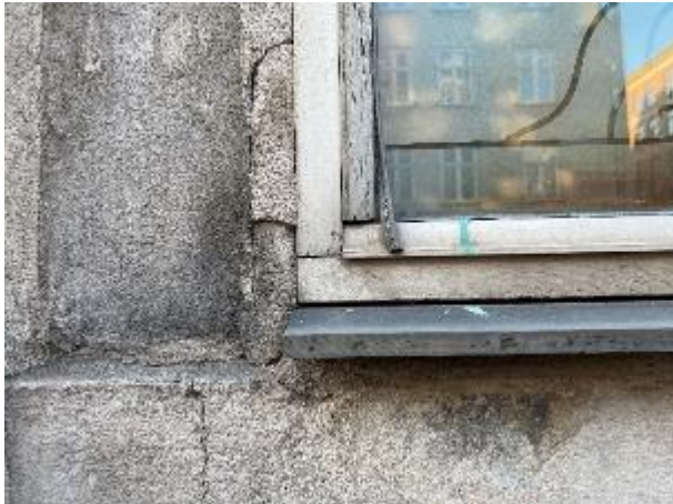
Skader i pudset underfacade ved vinduesparti mod gadesiden.
