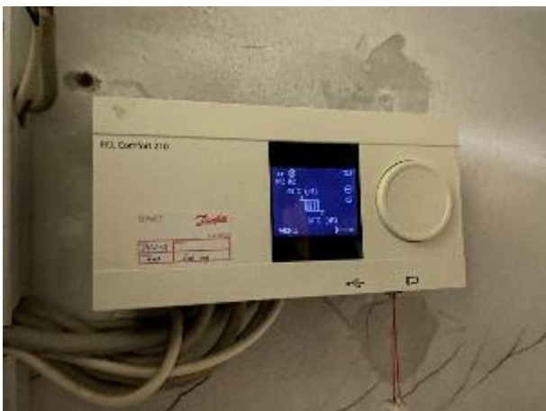
Vejkompenseringsanlæg på væg, Danfoss ECL-210
