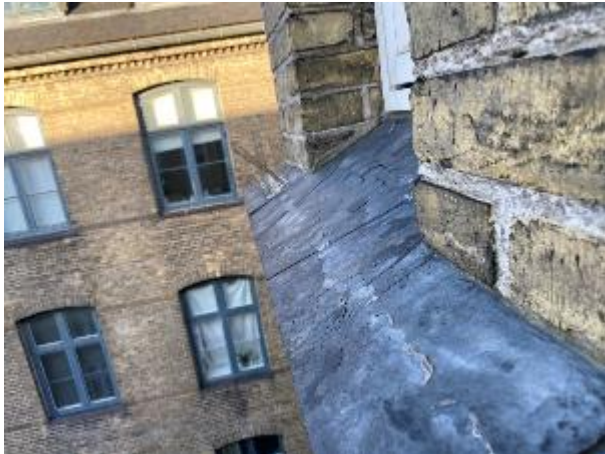
Sålbænke/gesimsbånd ses stedvis at være forvitret.
