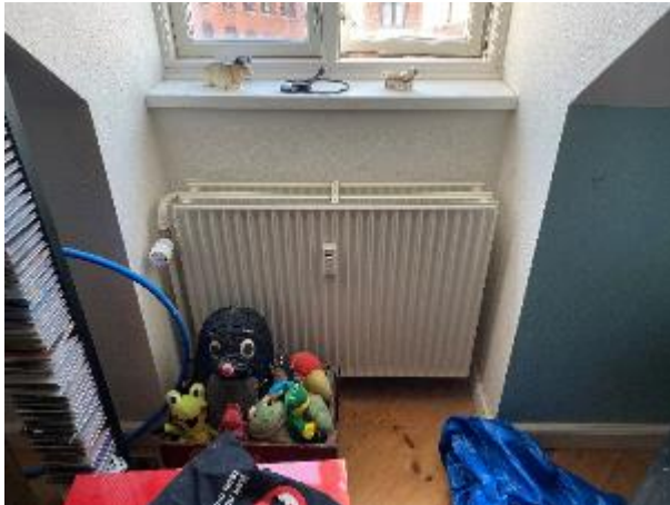
Panelradiator på væg i vinduesniche i tagbolig
