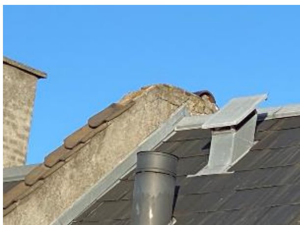
Afkasthætte fra udsugningsanlæg
