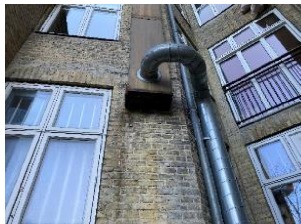
Rusten aftrækskanal på facaden giver grimme rustløbere på facaden.
