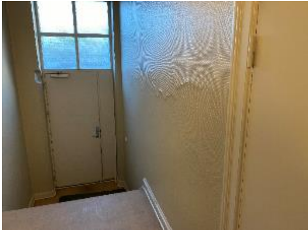
Trapperumsvægge ses flere steder at have løs – og endda stedvis udbulende – puds på væggene.
