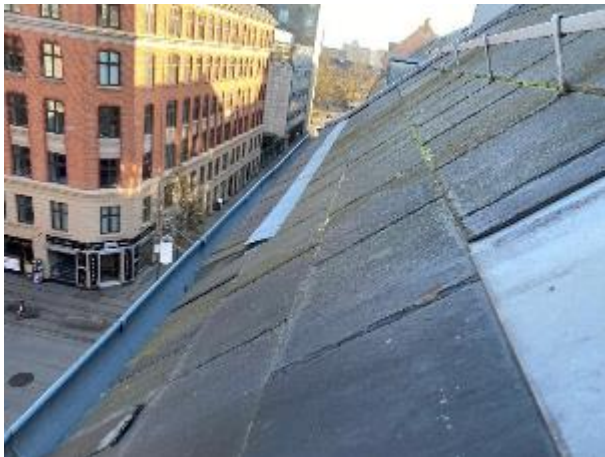
Tagbelægningen ligger generelt fint. En enkel smal skifer ses dog her at være skredet ned i tagrenden. Der er monteret snestopperjern da belægningen er relativt glat.
