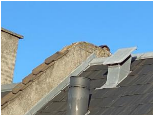
Enkelte afdækningssten på brandkammen mangler.
