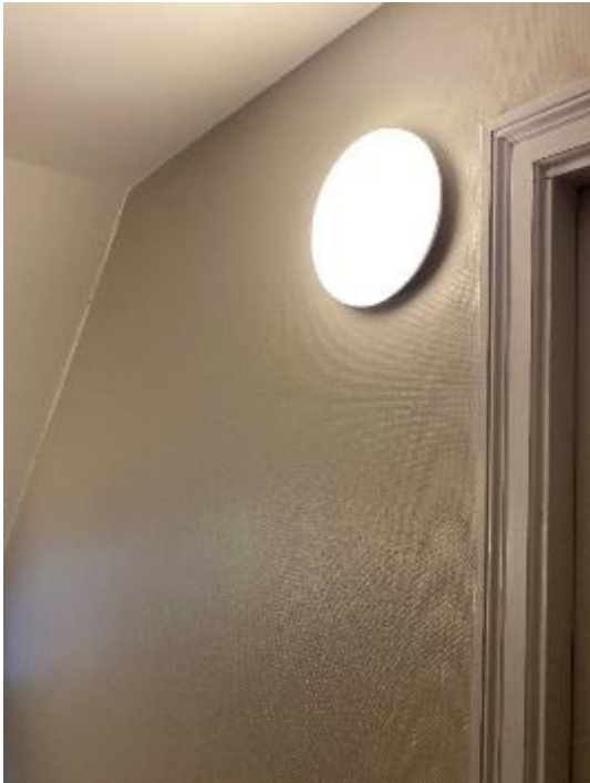
Belysningsarmatur på hovedtrappeopgange. Armaturet er med LED og intergreret bevægelsesmelder for automatisk tænd/sluk af loftbelysningen.
