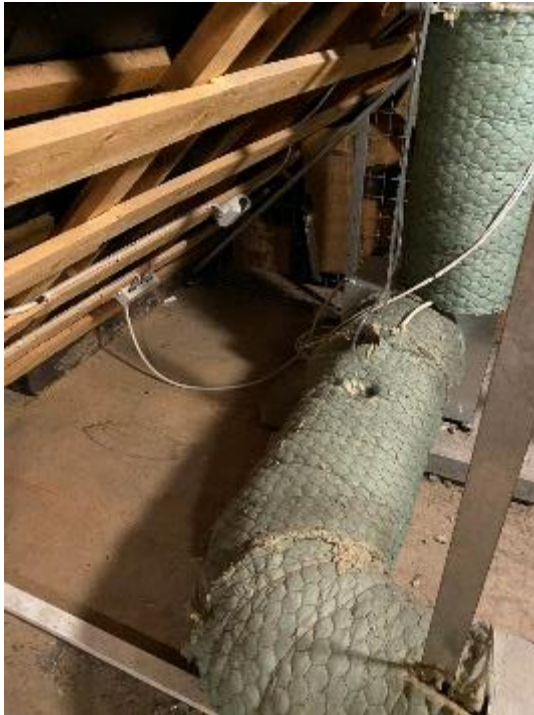
Fællesinstallationer og styring på loftet til centrale ventilationsanlæg/kontroludsugning til emhætter og badeværelser i boligerne.
