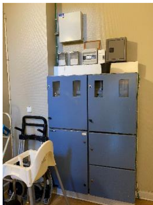
Endnu en fordelingstavle på en bagtrappe. Som ses er strømforsyning til porttelefonanlægget, samt TDC- og YouSee hovedfordelinganlæg placeret over tavlen.
