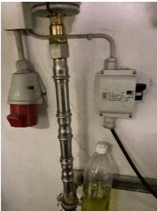
Fællesinstalltion i varmecentralen .
