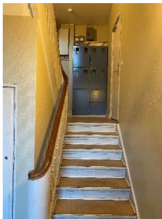
Endnu et eksempel på en fordelingstavle på en bagtrappe- Som ses er hovedforsyninger for YouSee og TDC, samt fællesinstallationer placeret over tavlen.
