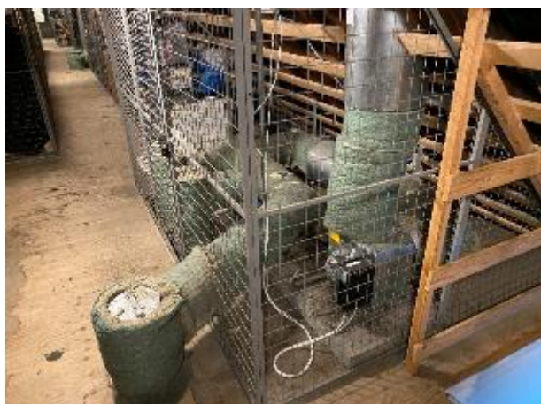
Exhausto boksventilator i loftrum placeret på flise med isoleret kanalsystem og afkast over tag
