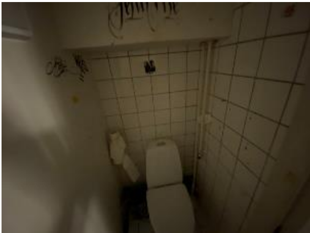
Toilet i kælder skal sikres mod opstuvning
