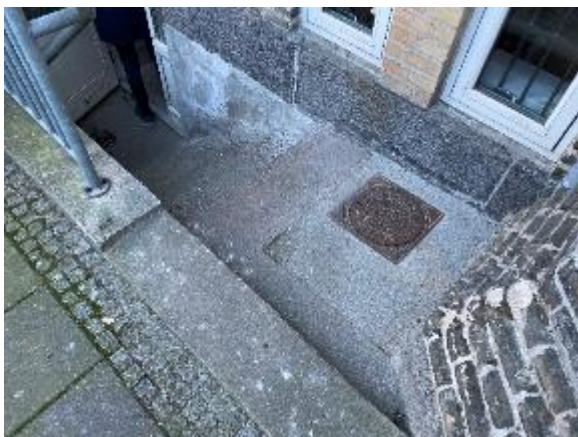
Vanger, trin og tilstødende belægninger er i god stand, og vand ledes væk fra trappen.
