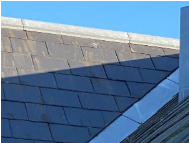
Der ses umiddelbart ikke at være indbygget ventilation i rygningen/ved kip.
