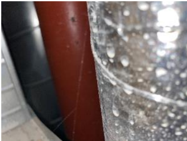
Faldstamme i installationsskakt (SML-rør)
