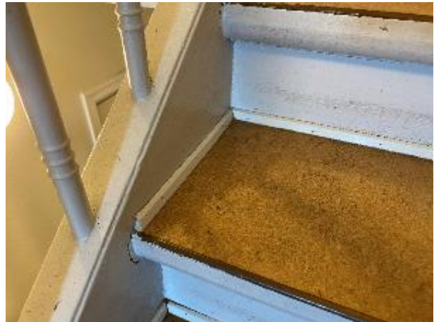
Trapper er belagt med linoleum med messingforkantslister og hvide kvartstaff lister af komposit/plast materiale.
