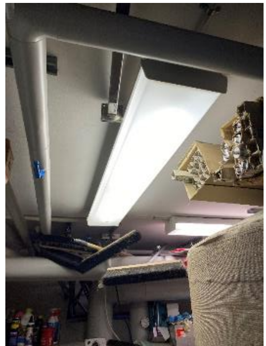
Traditionelt lysrørsarmaturer i varmecentralen.
