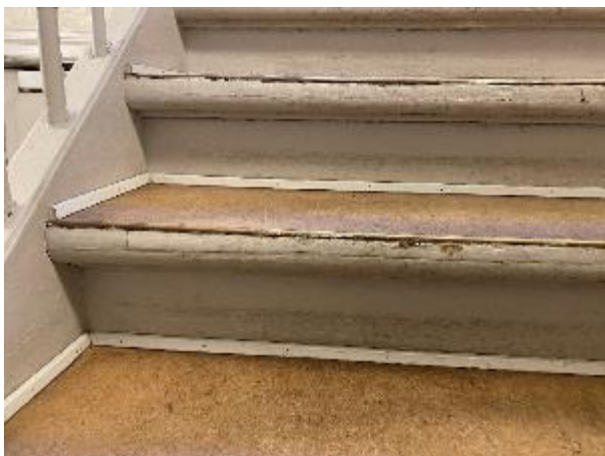
På den nederste del af trapperne ses trapperne at være oprettet med nye trinforkanter. Her skal man være opmærksom på at der kan være anvendt asbestholdigt materiale til opretningen af selve trinene.
