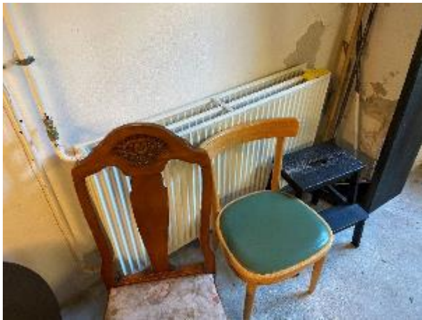
I kælderen er der stedvis opsat varmekilder. Dette er godt for fugtforholdene i kælderen.
