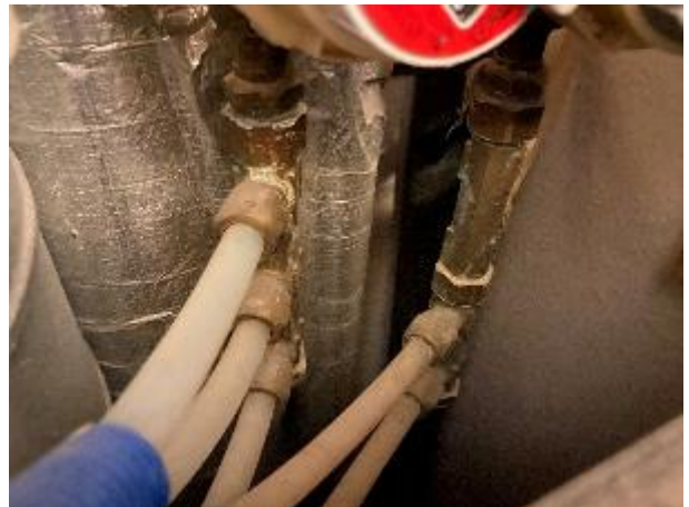
Irringer på messing fordelerrør og omløbere
