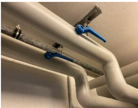
Isolerede brugsvandsrør i kældrer med kuglehaner (mesting) afsluttet med isogenopak, rørmærkninger mangler
