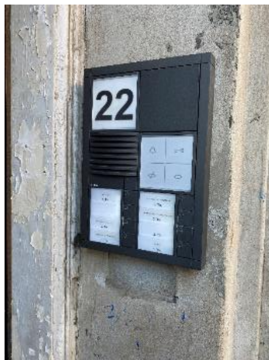
Hovedstation for porttelefonanlægget ved hoveddøren til en trappeopgang.
