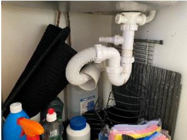
Vandlås under køkkenvask, nyere plastinstallation med forberedelse til opvaskemaskine
