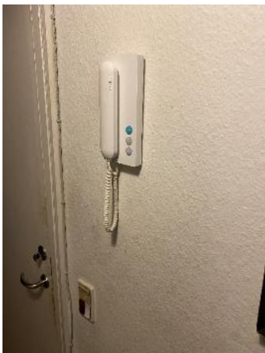
En svartelefon for porttelefonanlægget i en bolig.
