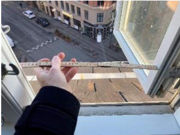
I en af de besigtigede lejligheder på kvisten, var der – på trods af en fri bredde mindre end 500 mm – ikke udført gående post til brandredningsåbning.
