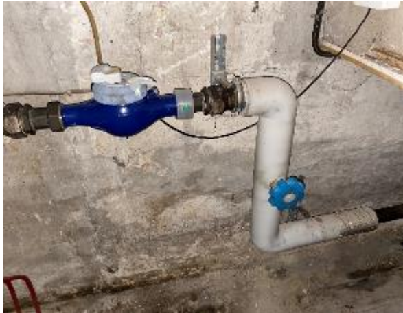
Vandstik og hovedmåler i kælderrum. Vandstik udført i galvaniseret stål.
