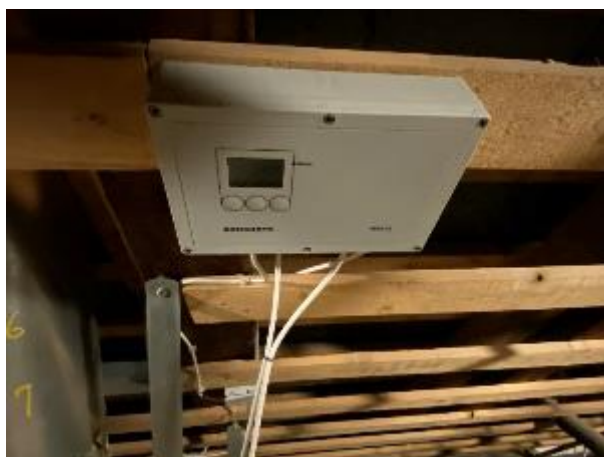
Automatik til styring af udsugningsanlæg
