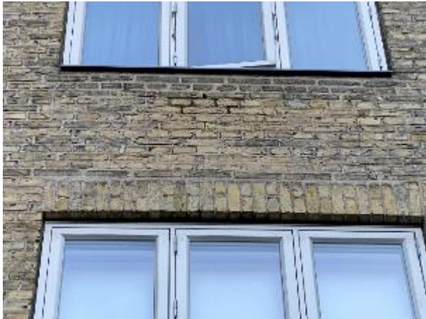
Stedvis ses manglende og/eller løse fuger i murværket.
