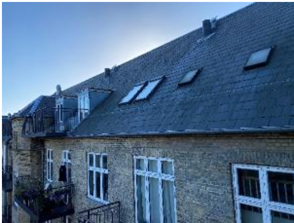
Tagbelægningen gennemrydes af kvistaltaner, aftrækshætter, ovenlys og tagvinduer
