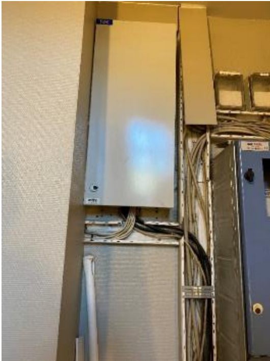
Antenne fordeleranlæg (YouSee) placeret på bagtrapper.
