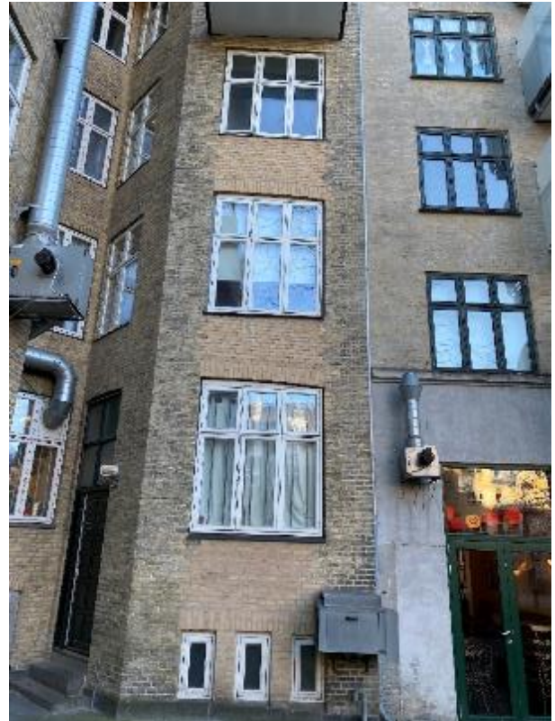
De murede brystninger er her ommuret – antageligt i forbindelse med vinduesudskiftning.
