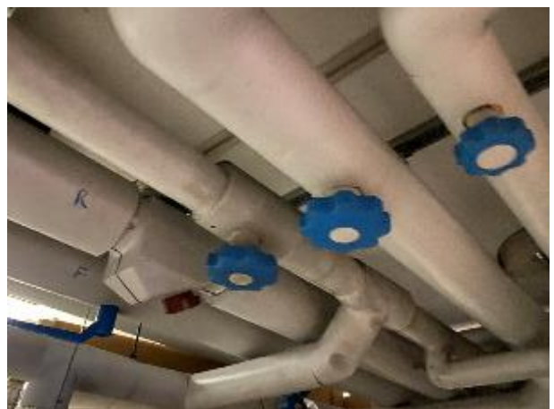
Isolerede brugsvandsrør i kældrer med sædeventiler (mesting) afsluttet med isogenopak, rørmærkninger mangler
