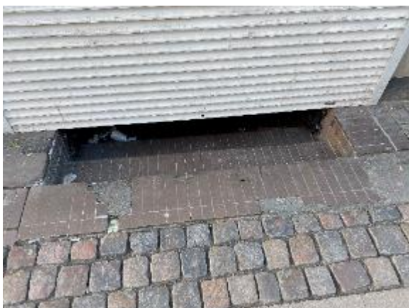
Udvendig trappe mod gadesiden. Her er trin belagt med klinker, der fremstår med en del slid og skader.
