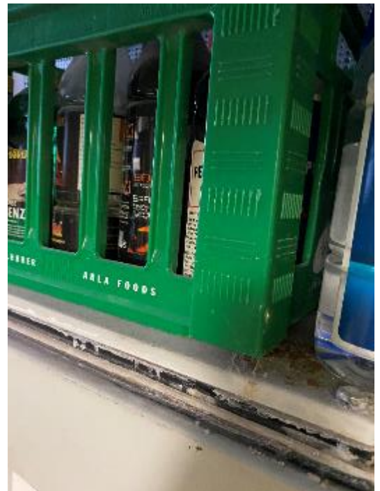
Synlige tegn på skader og nedbrydning af hovedtavlens kapsling som følge af opbevaring af kemikalier på tavlen. Det vides ikke om tavlen har indvendige skader.
