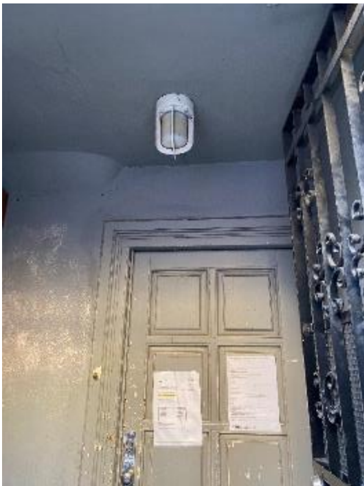
Belysningsarmatur placeret i indgangsparti ved hovedtrappeopgange.
