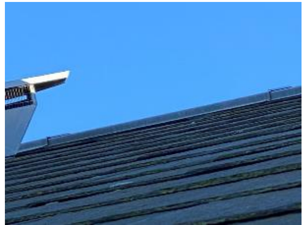
Der er ikke udført ventilationsspalte ved rygning/kip, og der ses heller ingen ventilationsstudse eller lignende i tagfladerne.
