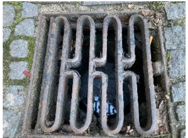
Ældre overflade afvandingsbrønd i gård
