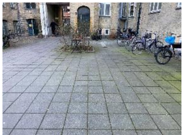
Belægninger i gården fremstår med fornuftigt fald og er generelt intakte.
