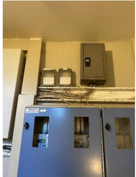
TDC's monopolskillepunkt (telefon - hovedforsyning) placeret på bagtrapper.
