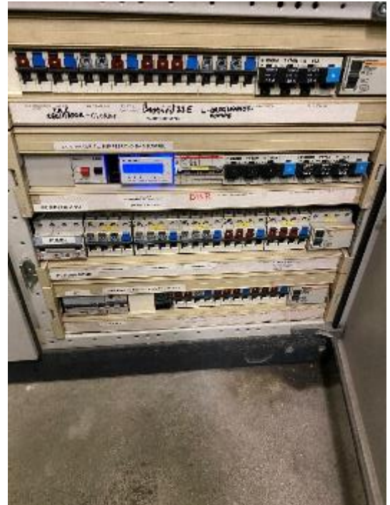
Sikringsmateriel i hovedtavlen. Der mangler enkelte afdækninger foran tavlemateriellet.
