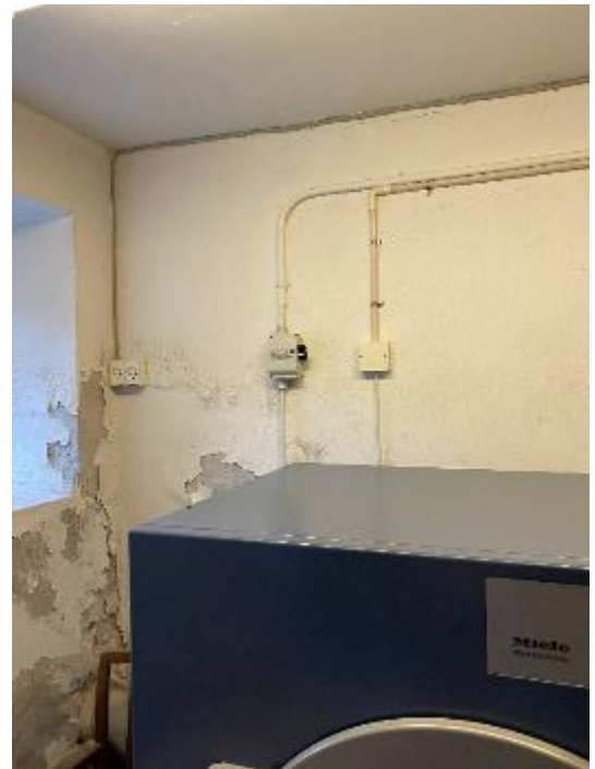
Fællesinstallation i vaskeriet som støder op til varmecentralen.
