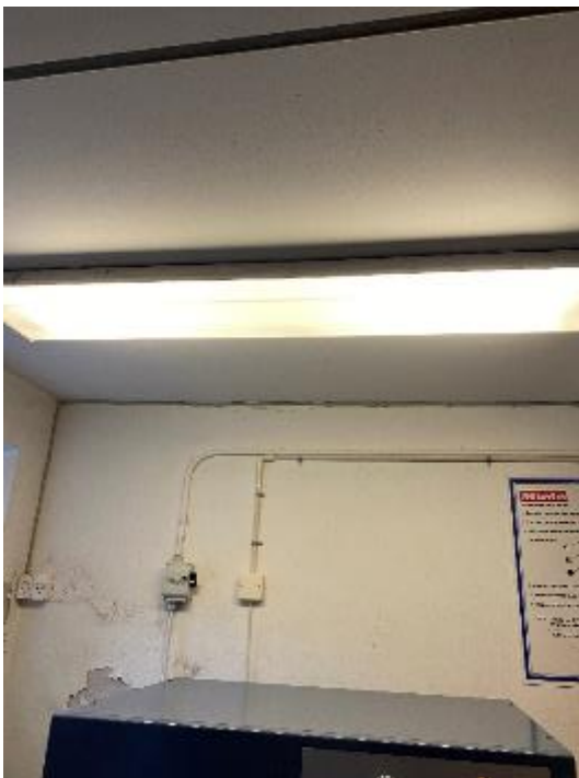
Traditionelt lysrørsarmaturer i vaskeriet.
