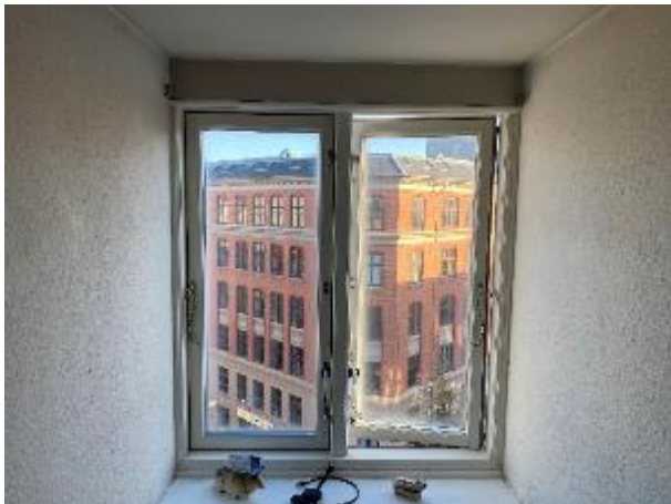
Vindue mod gadesiden med anverfere, PN beslag og stormjern.
