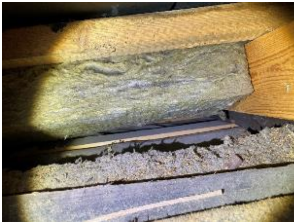
Afstand mellem overside isolering og underside skifer skal minimum være 50 mm. Det er ikke overholdt.
