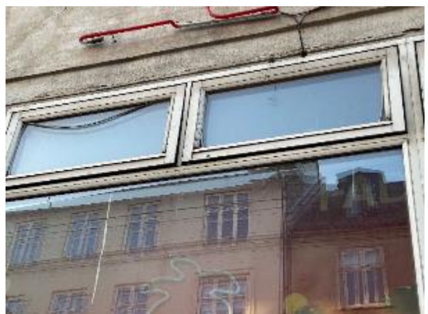
Vinduesparti mod gadeside ved erhverv fremstår slidt og med ødelagte glaslister
