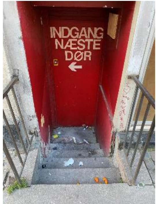
Udvendig trappe mod gadesiden udført af præfabrikerede trin i granit, samt med rækværk af stål (delvist indstøbt i mur)
