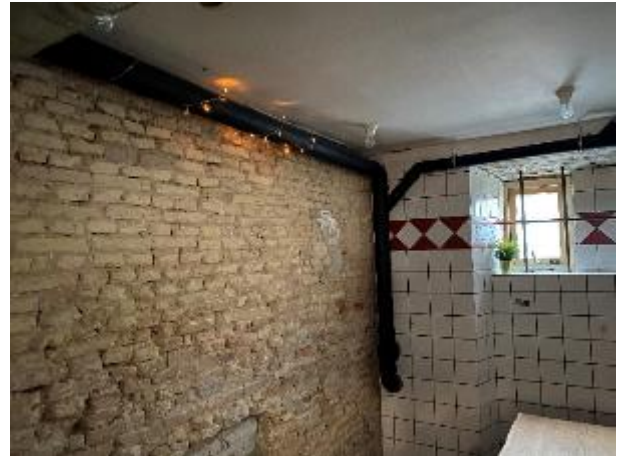
Afløbsinstallation/ faldstamme i kælder (mangler rottestop)
