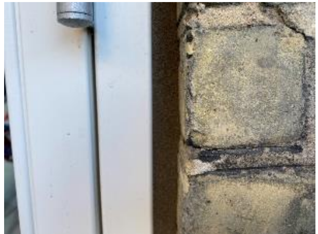
Kalfatringsfuger til nyere altanpartier er udført med ekspansionsfugebånd.
