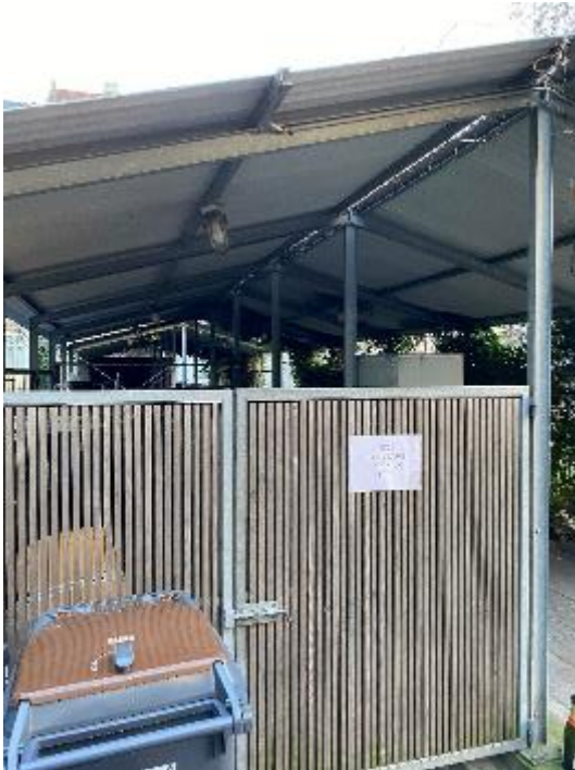
Udvendig belysningsarmaturer i det udvendige skur i baggården.
