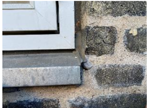
Afslutning af zinksålbænk i murværk er (lidt klodset) her afsluttet med fugt. Vær opmærksom på fugens begrænsede levetid.
